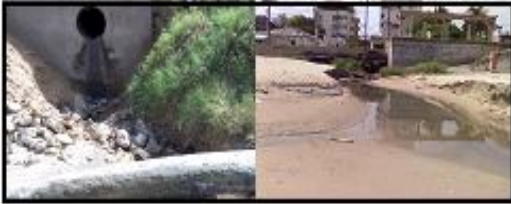
Figura 19. Descarga de aguas residuales en la playa de Riohacha. Fuente: propia (2011).
